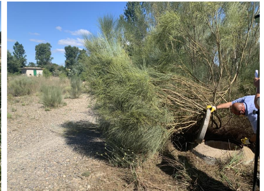
Pozo de incorporación a la red de saneamiento de Zaragoza
