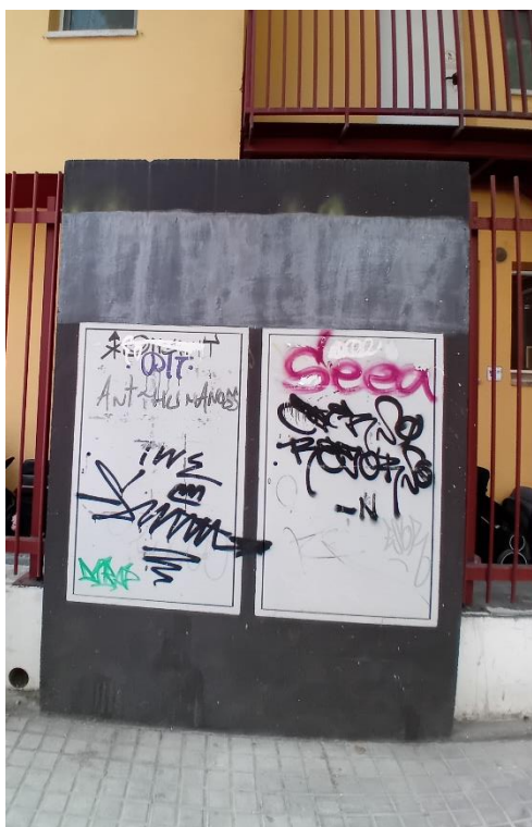
Figura 1. Armario de Seccionamiento y Protección del centro E.I. La Piraña. Ubicado en el exterior del edificio, en C/ del Monasterio de Samos.
