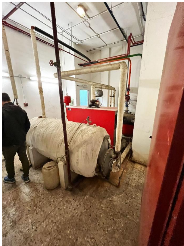
Imagen 12: Foto interior de la sala de calderas
