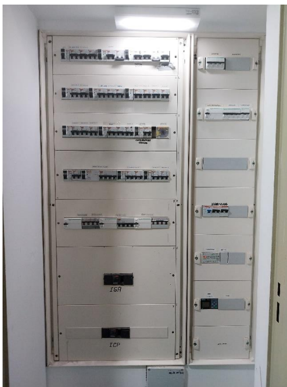
Figura 2. Cuadro General de Baja Tensión existente.
