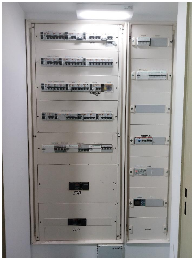
Imagen 12: Foto del cuadro eléctrico
