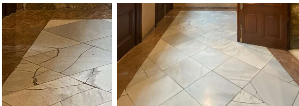
Imágenes de grietas y fisuras en el pavimento del vestíbulo 1
