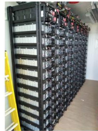
Racks de Baterías
