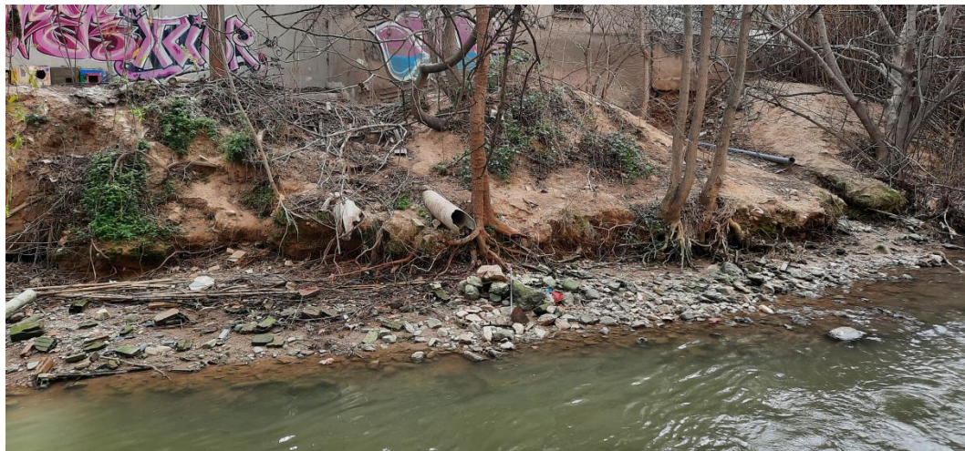
Figura 25. Orilla derecha del río Huerva (tramo del lote 1) donde se aprecia el elevado grado de incisión y parte del sistema radicular de los árboles de la margen derecha al desnudo
