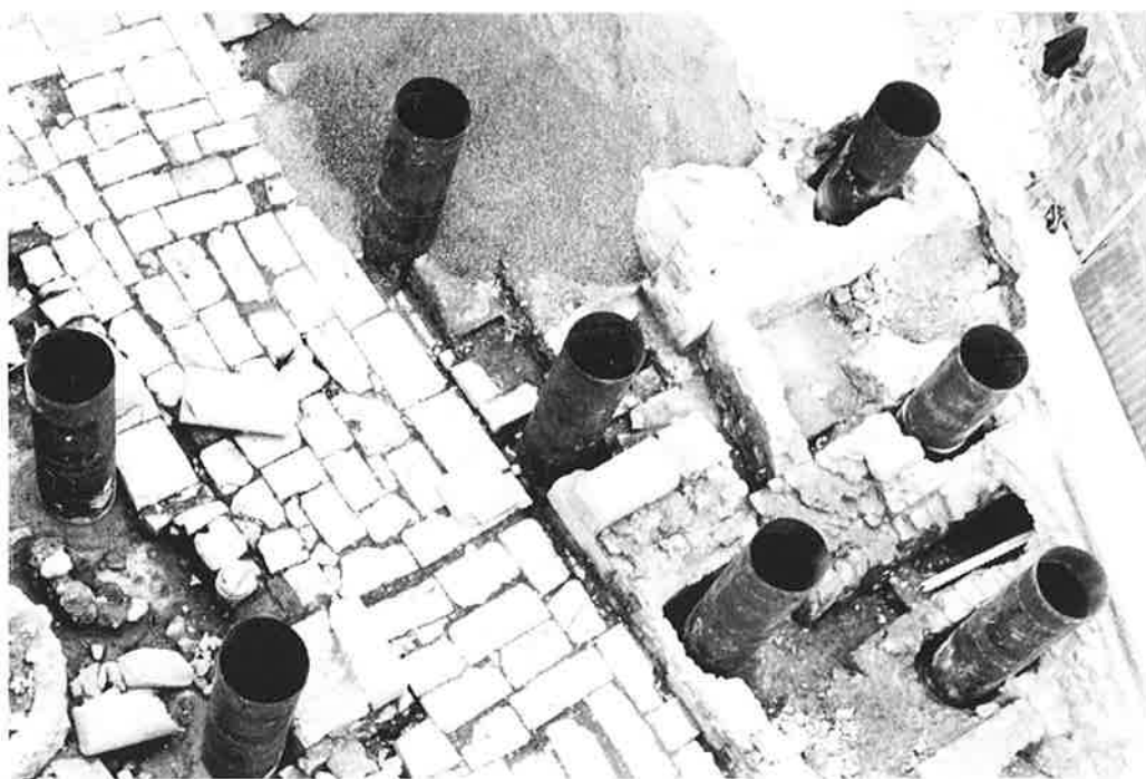
8.— Las operaciones de colocación de tubos metálicos para los pilotes de cimentación y relleno total con arena.
