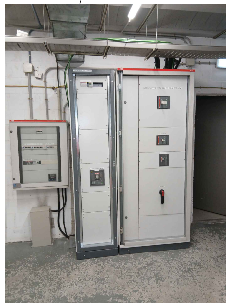
CUADRO GENERAL DE BAJA TENSIÓN EN BIBLIOTECA MARÍA MOLINER
