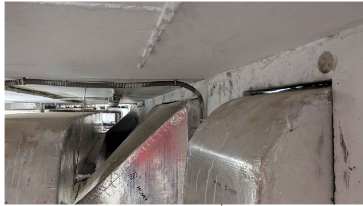
GALERÍA DE INSTALACIONES
