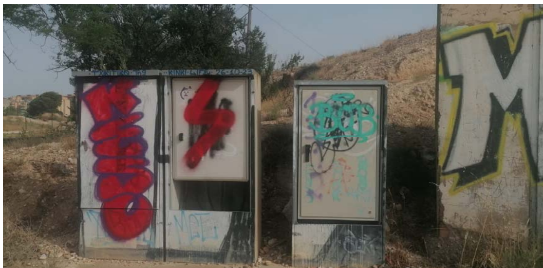
Imagen 1. Estado actual de los subcuadros.
